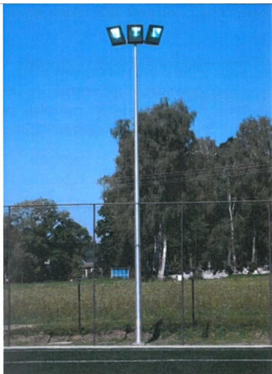
4 fundamenty, 4 maszty, 12 naświetlaczy
